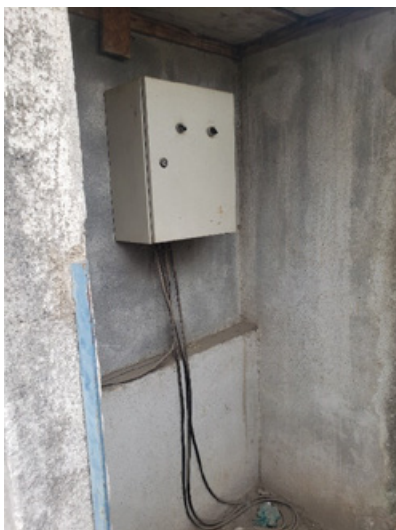
FIGURA 6-6 – EEE AV. MAGALHÃES – QUADRO ELÉTRICO
