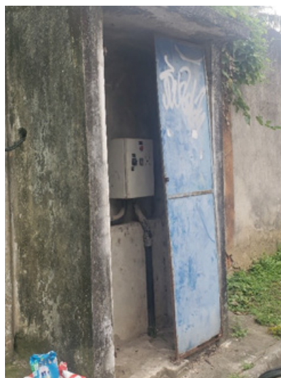
FIGURA 6-82 – EEE ALVORADA – ABRIGO DE QUADRO ELÉTRICO
