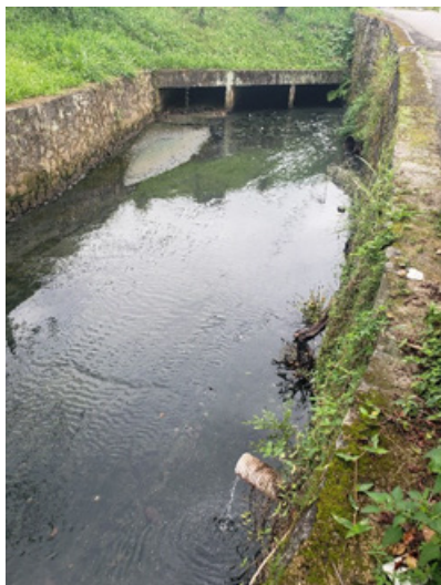
FIGURA 6-51 – EEE RAIMUNDO CAPRIANO – EXTRAVASSOR LANÇANDO EM CANAL DE DRENAGEM
