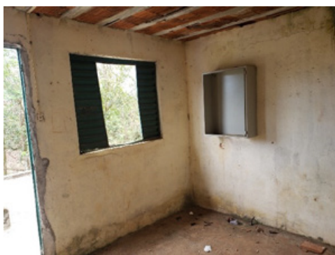
FIGURA 6-21 – ETE PARQUE MAMBUCABA – ABRIGO DO QUADRO ELÉTRICO
