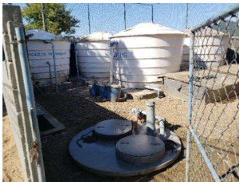
FIGURA 6-154 – ETE VILA VELHA – VISTA GERAL INCLUINDO EEE E SISTEMA DE RAC+BAS
