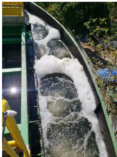
FIGURA 6-126 – ETE PRAIA DA CHÁCARA – PÓS-TRATAMENTO AERADO
