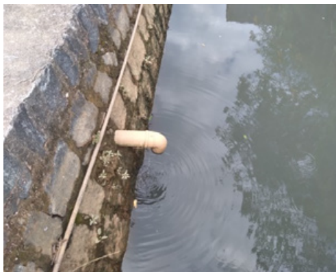
FIGURA 7-16 – LANÇAMENTO DE ESGOTO EM CANAL DE DRENAGEM
