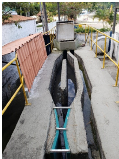
FIGURA 6-135 – ETE – TRATAMENTO PRELIMINAR
