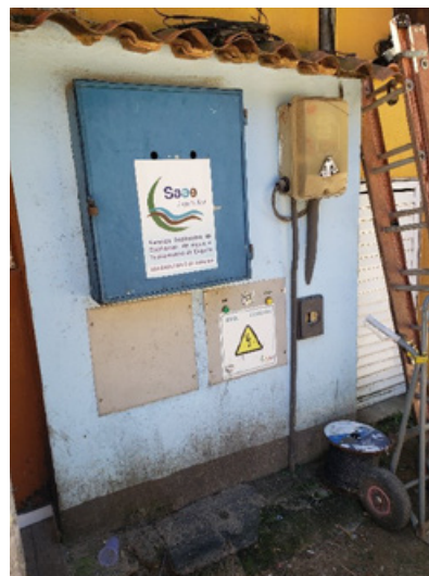
FIGURA 6-189 – EEE 04 – PADRÃO COM QUADRO ELÉTRICO
