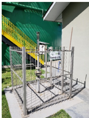
FIGURA 6-131 – ETE PRAIA DA CHÁCARA – QUEIMADOR DE GÁS
