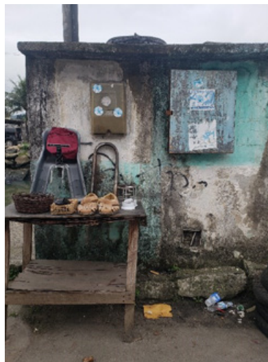
FIGURA 6-88 – EEE TARARACA – PADRÃO DE QUADRO ELÉTRICO
