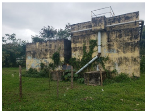
FIGURA 6-56 – ETE FRADE – REATOR UASB E FILTRO ANAERÓBIO
