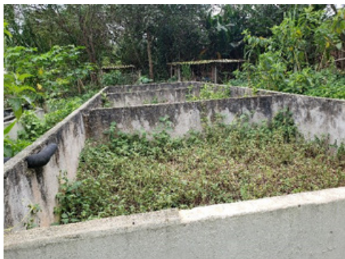
FIGURA 6-76 – LEITO DE SECAGEM DE LODOS
