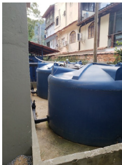
FIGURA 6-138 – ETE – TANQUES DE EQUALIZAÇÃO
