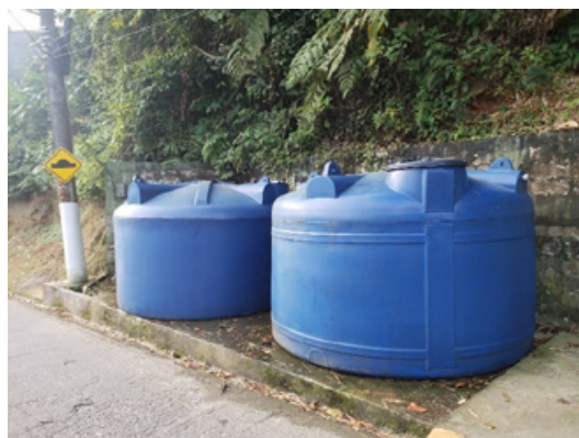
FIGURA 5-92 – VISTA DOS RESERVATÓRIOS – SAA BONFIM 02
