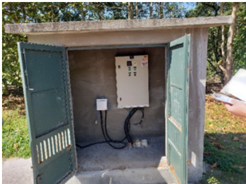
FIGURA 6-119 – EEE HOTEL – QUADRO ELÉTRICO
