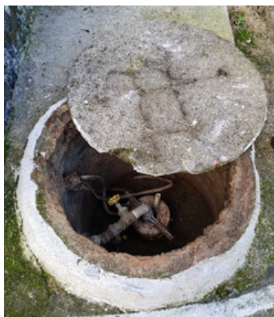
FIGURA 5-90 – VISTA DO POÇO ARTESIANO – SAA BONFIM 01
