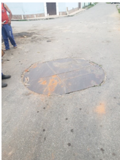
FIGURA 6-81 – EEE ALVORADA – VISTA GERAL
