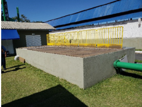
FIGURA 6-121 – ETE PRAIA DA CHÁCARA – CAIXA DE GORDURA
