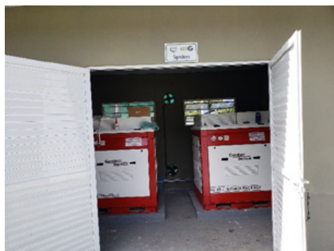
FIGURA 6-127 – ETE PRAIA DA CHÁCARA – SOPRADORES
