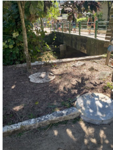
FIGURA 6-187 – FILTRO LOCALIZADO ENTRE A EEE 05 E EEE 04
