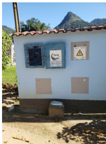
FIGURA 6-195 – EEE 02 – PADRÃO COM QUADRO ELÉTRICO
