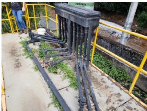
FIGURA 6-137 – ETE – CAIXA DE DISTRIBUIÇÃO DO RAFA
