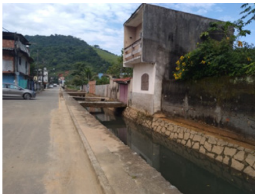
FIGURA 7-17 – OCUPAÇÃO DAS MARGENS DOS CANAIS DE DRENAGEM
