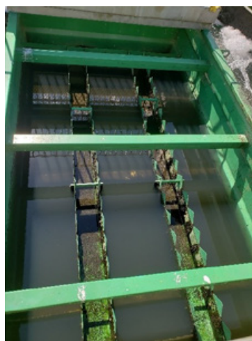
FIGURA 6-128 – ETE PRAIA DA CHÁCARA – DECANTADOR
