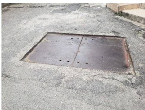
FIGURA 6-85 – EEE MACAÉ – VISTA GERAL
