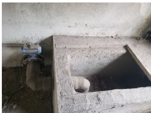
FIGURA 6-20 – ETE PARQUE MAMBUCABA – EEE
