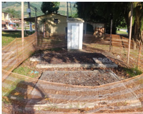
FIGURA 6-175 – ESTAÇÃO ELEVATÓRIA DA ETE MONSUABA
