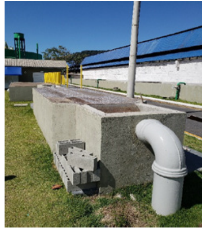
FIGURA 6-122 – ETE PRAIA DA CHÁCARA – TRATAMENTO PRELIMINAR GRADEAMENTO
