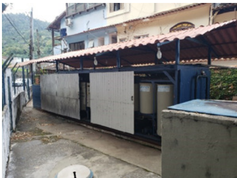
FIGURA 6-139 – ETE – TRATAMENTO FÍSICO-QUÍMICO
