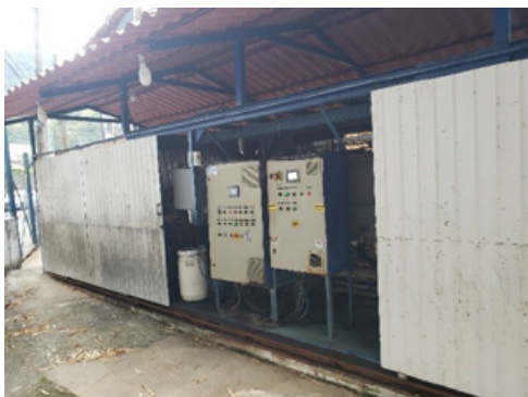
FIGURA 6-141 – ETE – TRATAMENTO FÍSICO-QUÍMICO – QUADROS ELÉTRICOS
