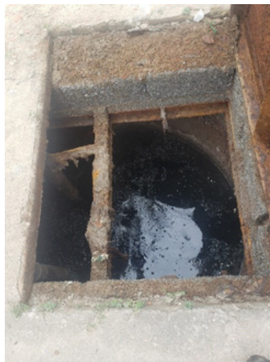
FIGURA 6-80 – EEE PALMIRA – POÇO DE SUCÇÃO
