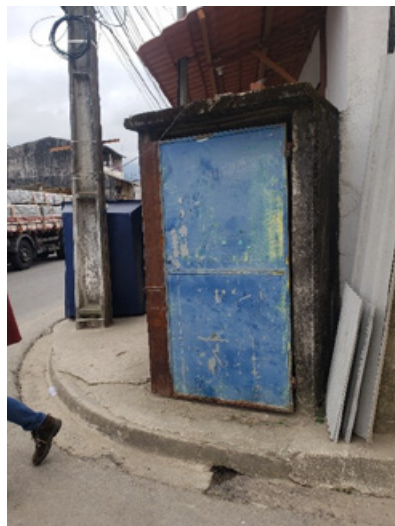
FIGURA 6-5 – EEE AV. MAGALHÃES – ABRIGO DO QUADRO ELÉTRICO
