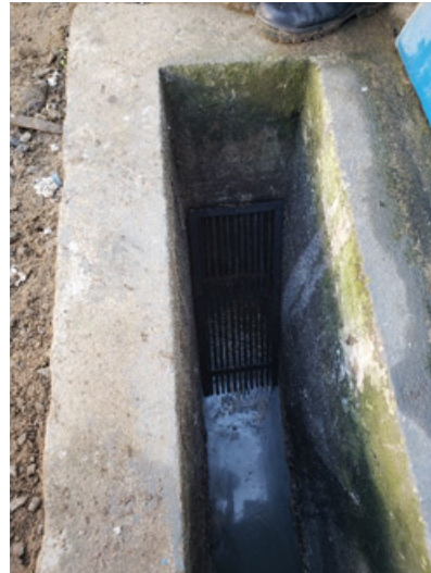
FIGURA 6-150 – ETE VILA VELHA – TRATAMENTO PRELIMINAR GRADEAMENTO
