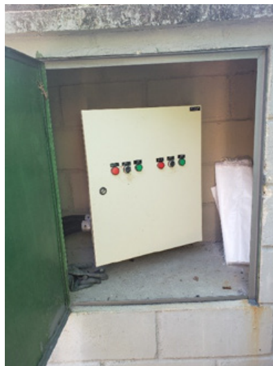
FIGURA 6-206 – ETE PROVETÁ – EEE – QUADRO ELÉTRICO
