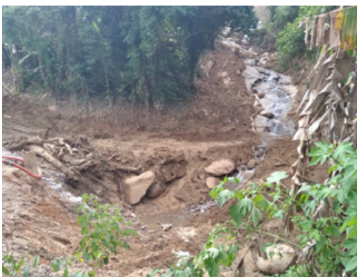
FIGURA 7-12 – ESCORREGAMENTO NA ESTRADA PARA PONTA LESTE
