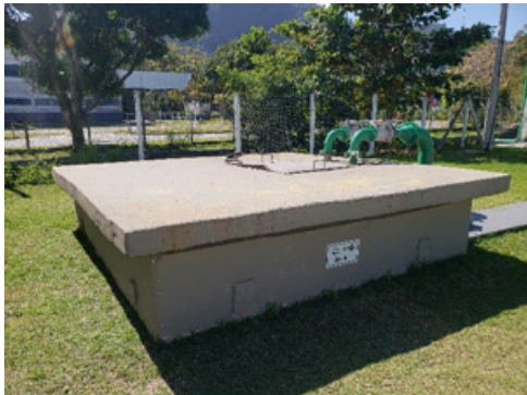
FIGURA 6-123 – ETE PRAIA DA CHÁCARA – TANQUE DE EQUALIZAÇÃO
