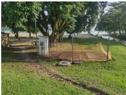
FIGURA 6-174 – ESTAÇÃO ELEVATÓRIA DA ETE MONSUABA
