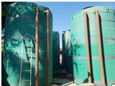
FIGURA 6-207 – ETE PROVETÁ – TANQUES DE TRATAMENTO
