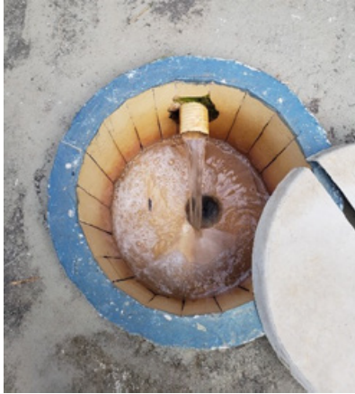
FIGURA 6-143 – ETE – EFLUENTE FINAL
