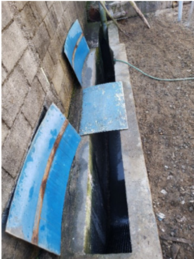
FIGURA 6-149 – ETE VILA VELHA – TRATAMENTO PRELIMINAR
