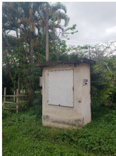
FIGURA 6-50 – EEE RAIMUNDO CAPRIANO – QUADRO DE COMANDO
