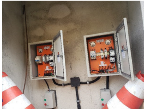
FIGURA 6-64 – EEE – QUADROS DE COMANDO - SES SÃO SEBASTIÃO
