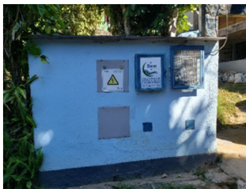
FIGURA 6-183 – EEE 06 – PADRÃO COM QUADRO ELÉTRICO
