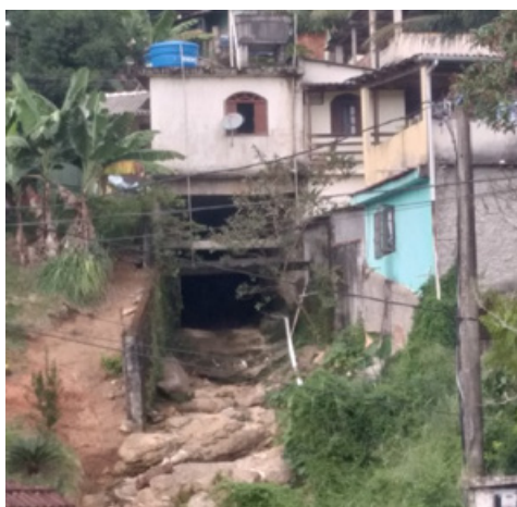
FIGURA 7-18 – EDIFICAÇÃO SOBRE GALERIA DE ÁGUA PLUVIAL
