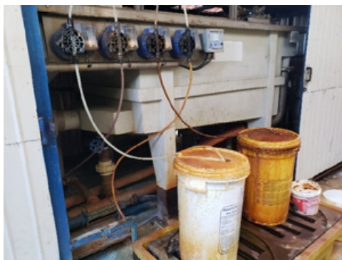
FIGURA 6-142 – ETE – TRATAMENTO FÍSICO-QUÍMICO
