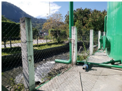
FIGURA 6-129 – ETE PRAIA DA CHÁCARA – LANÇAMENTO FINAL
