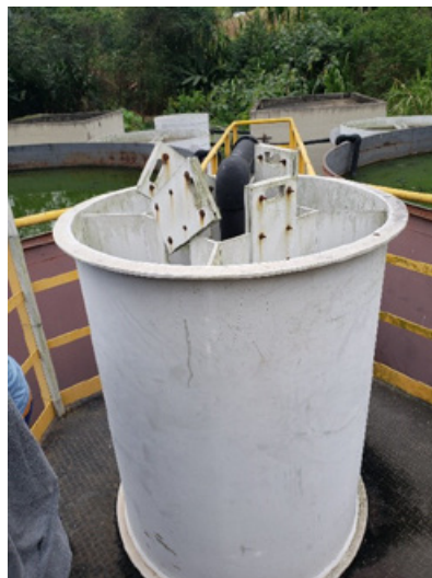
FIGURA 6-73 – CAIXA DE DISTRIBUIÇÃO DOS TANQUES DE AERAÇÃO
