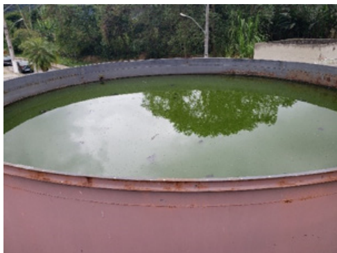
FIGURA 6-72 – TANQUE DE AERAÇÃO
