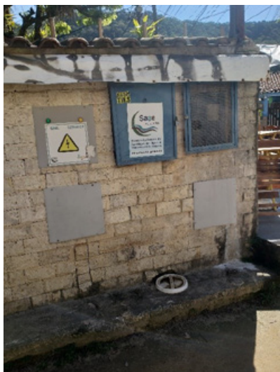
FIGURA 6-192 – EEE 03 – PADRÃO COM QUADRO ELÉTRICO
