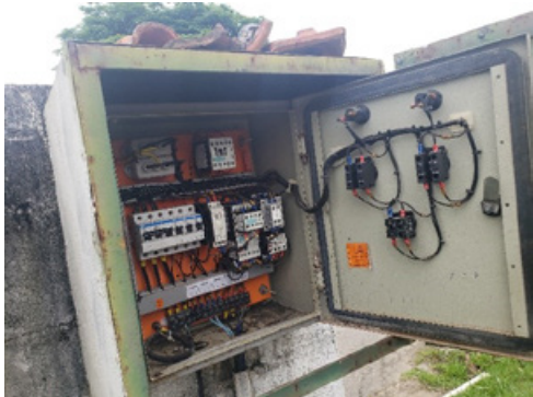
FIGURA 6-38 – EEE 03 – QUADRO DE COMANDO
