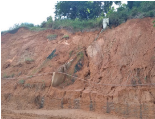
FIGURA 7-10 – ESCORREGAMENTO NA ESTRADA PARA PONTA LESTE
