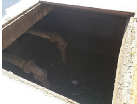
FIGURA 6-118 – EEE HOTEL – POÇO DE SUCÇÃO
