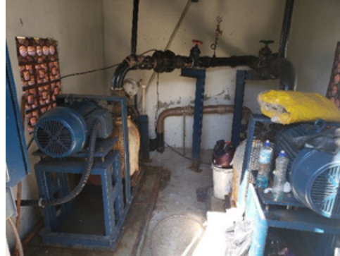
FIGURA 6-109 – EEE ANIL – CONJUNTOS MOTO- BOMBA
