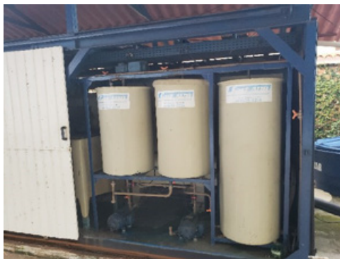
FIGURA 6-140 – ETE – TRATAMENTO FÍSICO-QUÍMICO
