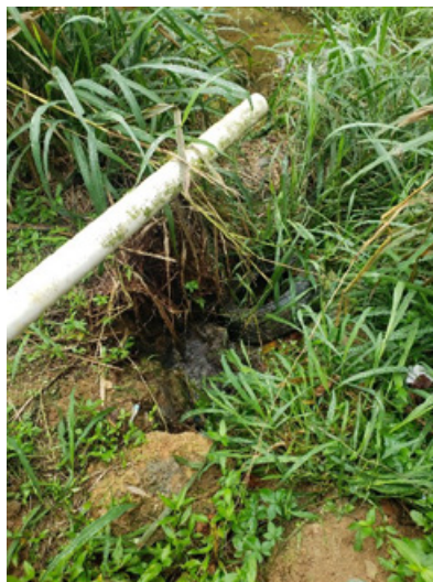
FIGURA 6-59 – LANÇAMENTO DE ESGOTO EM TERRENO
