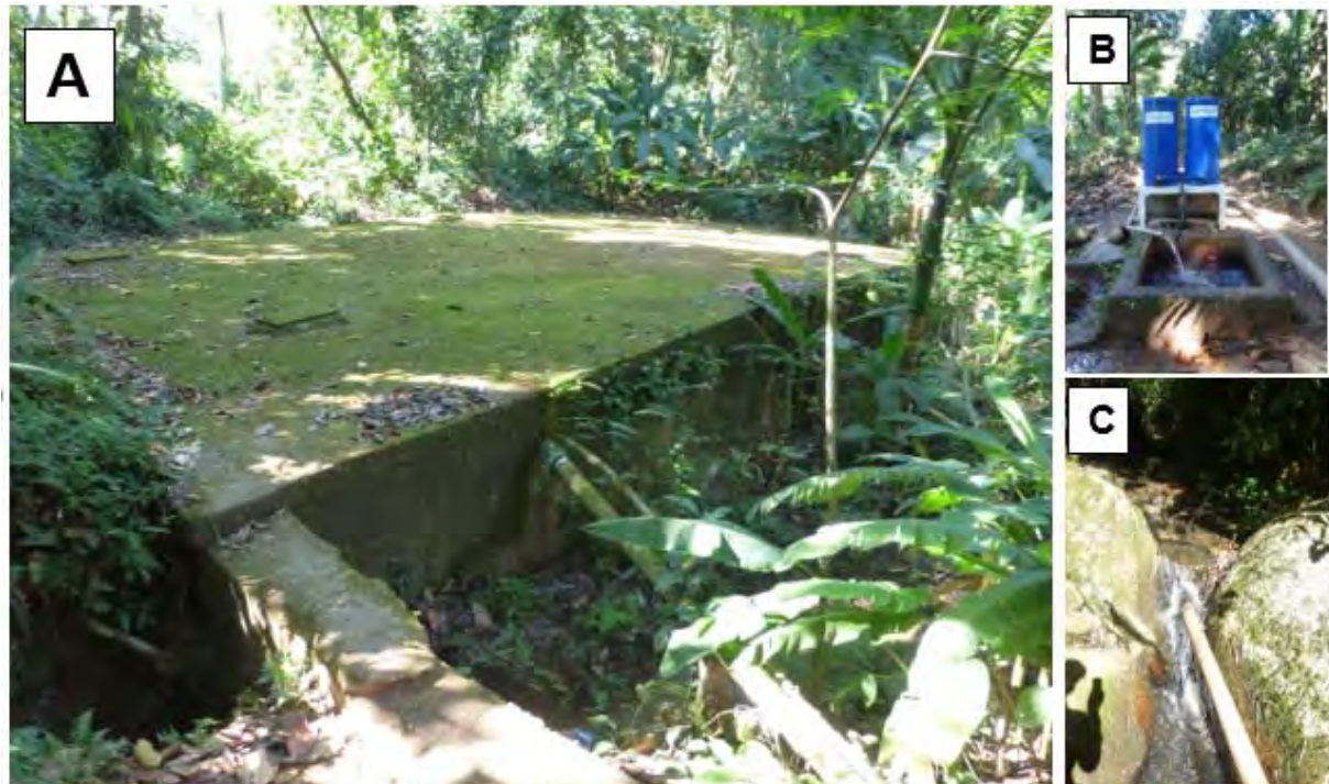
Figura 3.1-53: Em A), cisterna operada pela SAAE, localizada na Universidade Federal Fluminense (UFF) e que abastece o bairro do Retiro (localização: 0568250/7456485, elevação 38m); em B) Clorador de água da cisterna; em C) Captação no Córrego do Retiro. Fotografia de João P.C. Araújo (julho de 2019)
