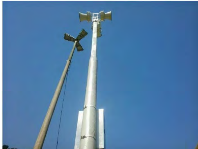
Figura 3.1-31: As sirenes fazem parte das medidas de ações emergenciais a serem tomadas em caso de situações de risco iminente. Fonte: Lousada e Farias (2014).
