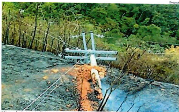
O fogo pode atingir a rede elétrica, causando interrupções no fornecimento de energia
