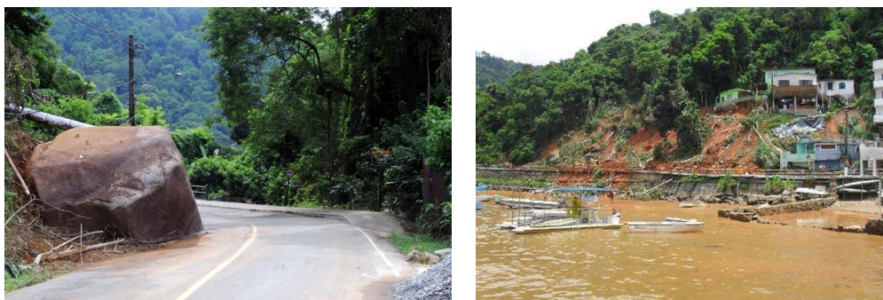
Figura 41 – Escorregamentos e quedas de blocos que ocorrem com frequência ao longo da estrada em períodos de chuva intensa, dificultando e, muitas vezes, impedindo o acesso às localidades e praias.
